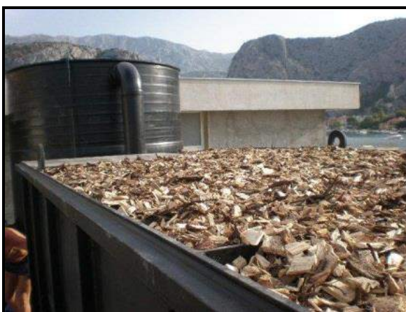
Slika 2.1.2-3. Biofilter u postojećem UPOV Omiš-Priko
